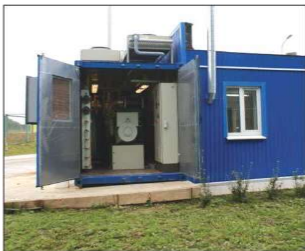
Рис. 5. Контейнер газопоршневой когенерационной установки.
